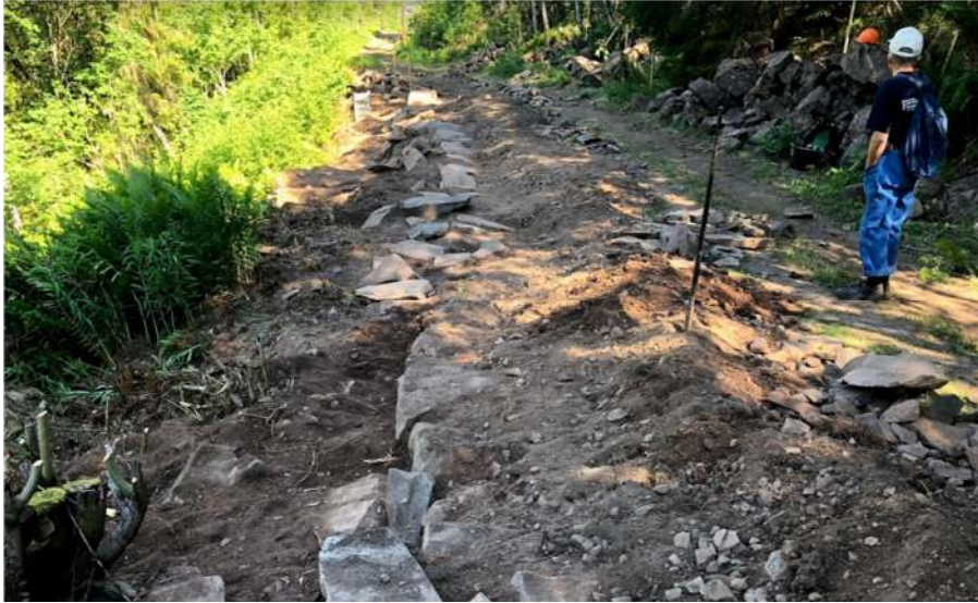
Figur 31: "Arkeologisk" avdekking av skadet vegmur (mur 4 ved ca. pel 600). Det meste av muren er ute av lage.
