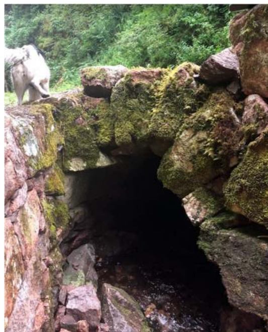
Figur 28: Innløpet til hvelvmurt stikkrenne ved pel 1260. Ledemuren til venstre utbedret.
