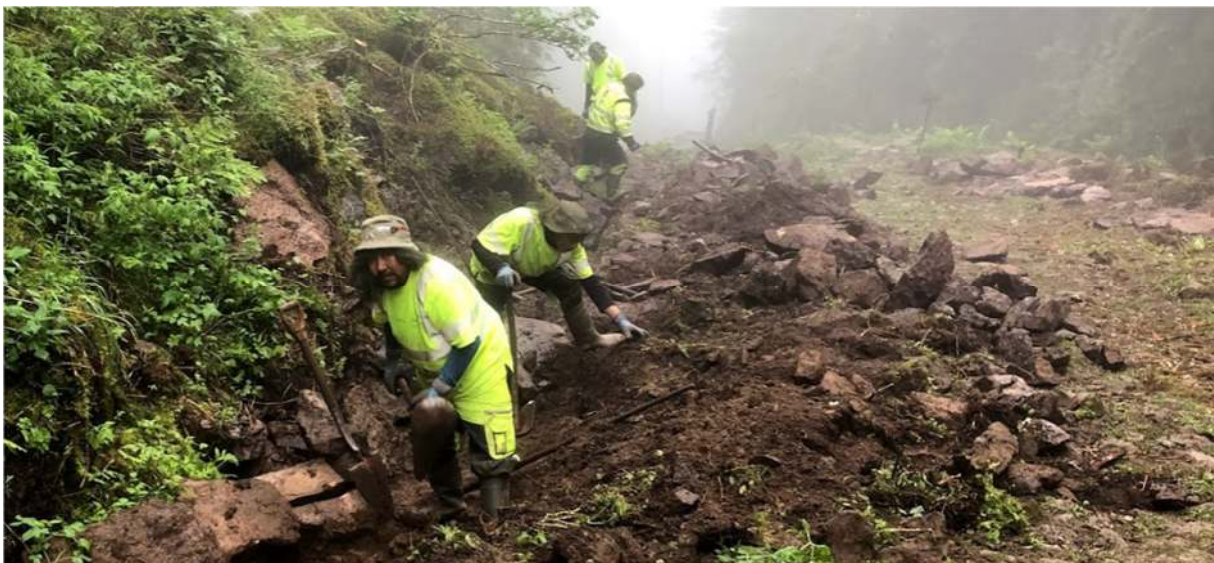
Figur 45: Tungt arbeid under myggnett kan tære på humøret! Mye stein og jord fra vegen var havnet i grøfta.
