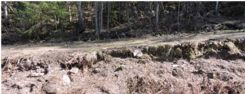
Figur 59: Mur 4 ved pel 610-620. Muren var svært gjengrodd og med utraste stein. Opprinnelig murhøyde skjules av løsmasser vasket ut fra vegdekket.
