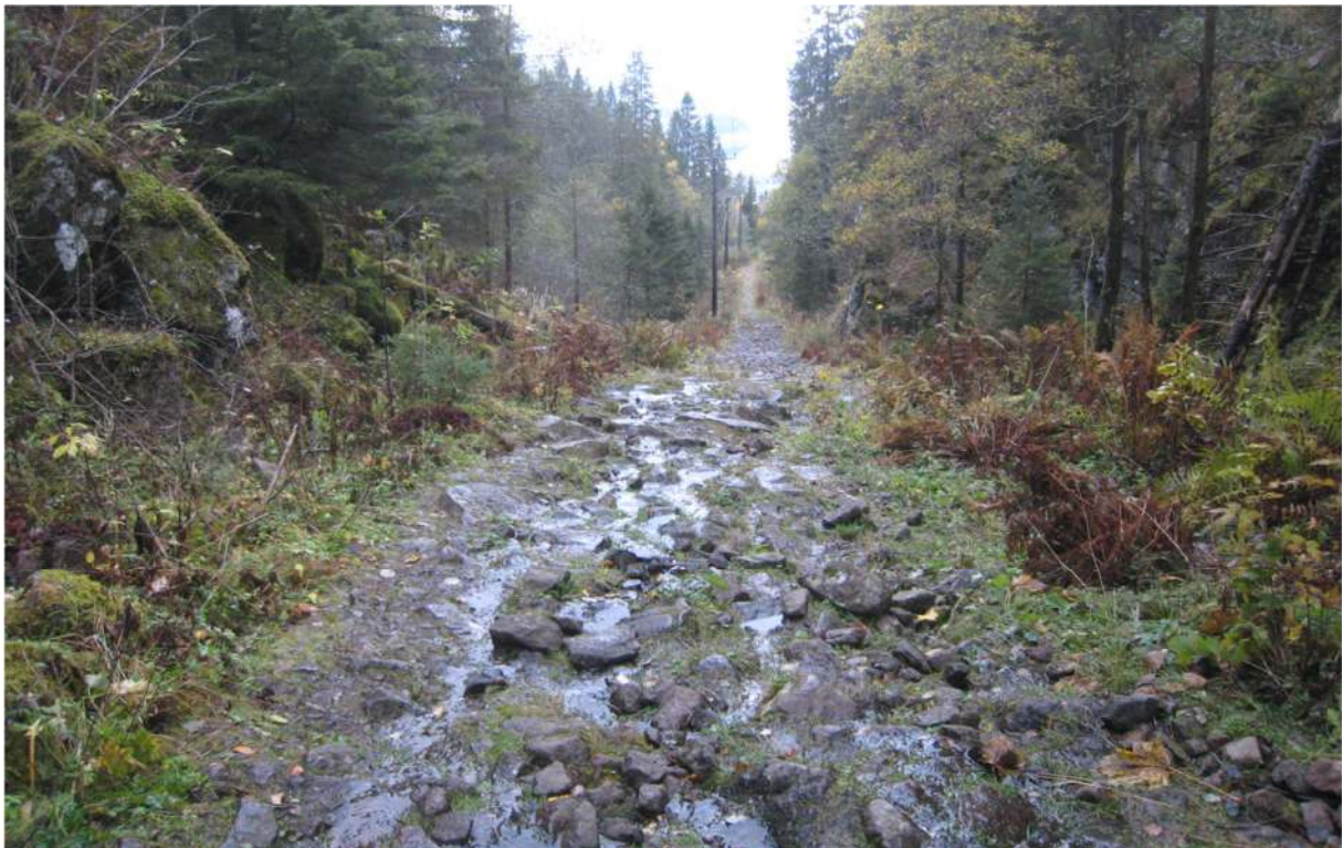
Figur 12: Tilstanden til Snobakken før istandsetting. Bilde tatt omtrent ved pel 1070. Se også Figur 5.
