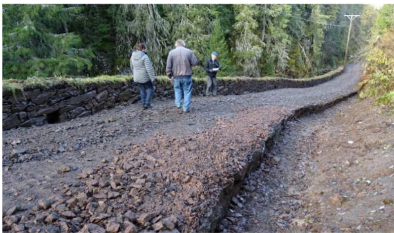
Figur 69: Samme sted som forrige bilde etter restaurering.
