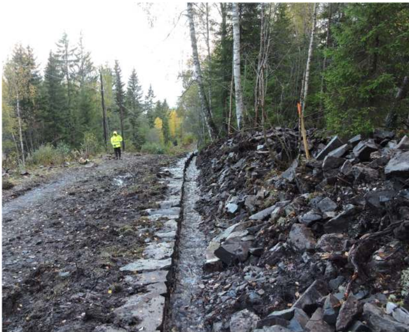
Figur 53: Grøft med steinsatt kant mot veg reetablert rett nedenfor Vanninga. Løsmassene i skråningen til høyre har senere blitt ryddet/planert.
