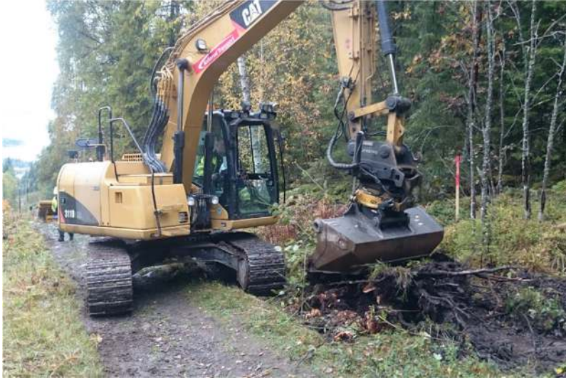
Figur 51: Bruk av kraftig gravemaskin var nødvendig for å få fjernet røtter som stod i vegggrøfta.
