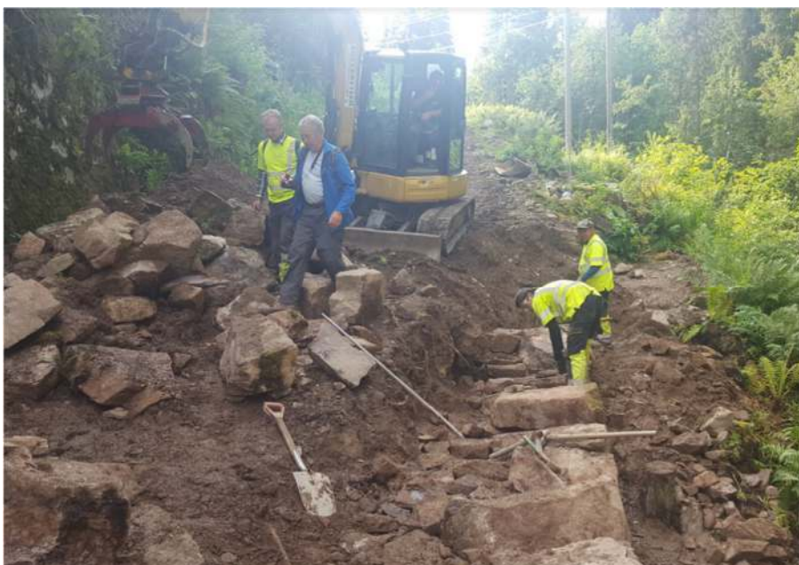
Figur 36: Istandsetting av mur 12. Gravemaskin brukes for å sortere og løfte fram stein. Murfoten bygges solid med store stein.
