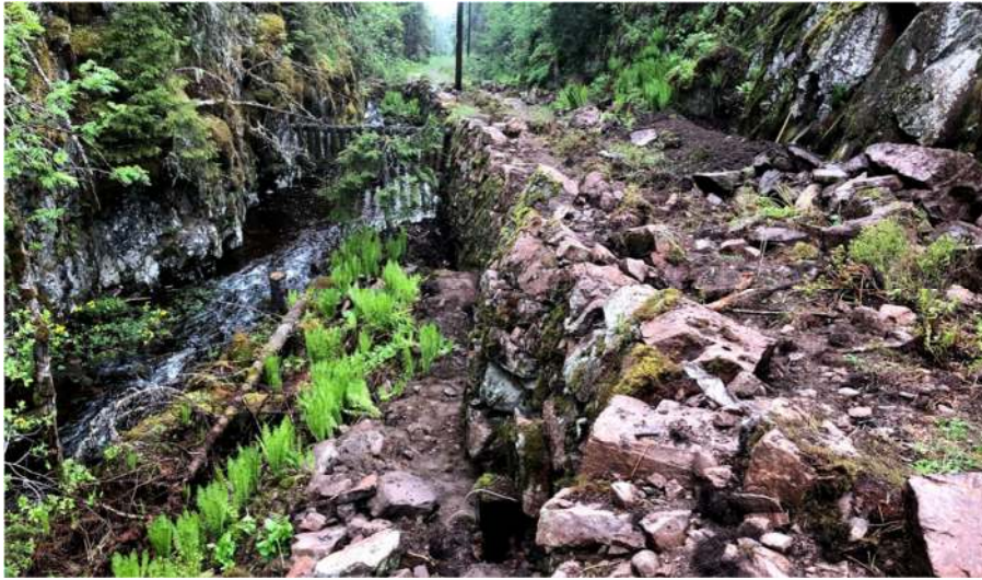
Figur 34: Store skader på mur 12 (ca. pel 1330). Muren buler ut og er ustabil.
