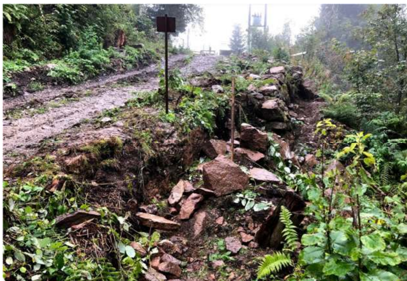
Figur 62: Mur 12 øverst i kleiva etter "arkeologisk" utgraving. Det meste av muren rast ut og ned skråningen mot bekk.
