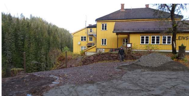
Figur 73: Avslutningen av prosjektet på toppen av bakken ved Kleivstua, ref. bilde over. Det skal monteres tradisjonell, dobbel tregrind på stolpene.
