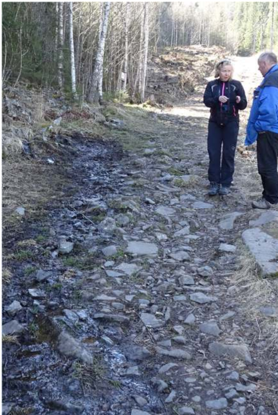
Figur 13: Ved Vanninga (pel 760) manglet grøft slik at vannet rant ut i vegbanen.
